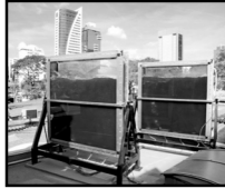
Sistema de tratamento de emissões atmosféricas. Fonte: TECPAR, 2012.
