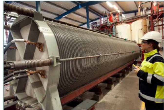
Eletrolisadores NEL (tecnologia Norsk Hydro BP)
