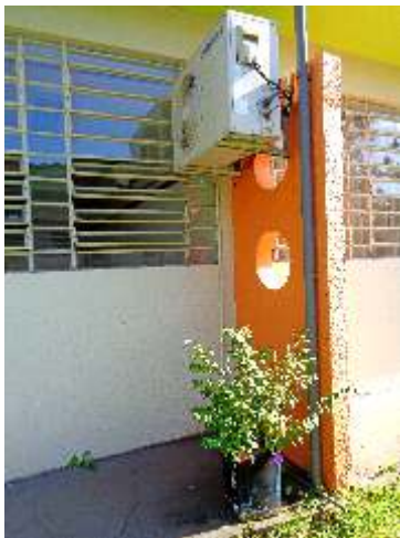
FIGURA 5 - Canalização da água do ar condicionado
