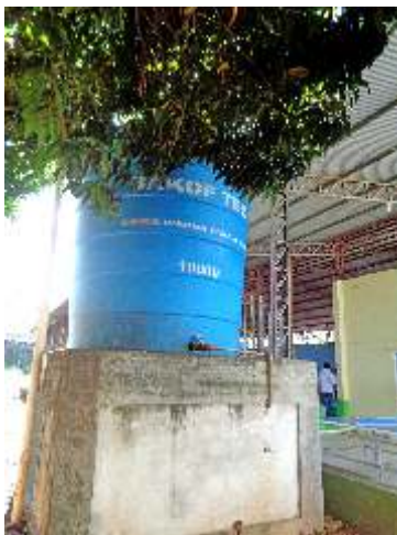
FIGURA 4 - Cisterna instalada no colégio
